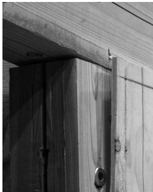
P : 大壁の合板の浮き
