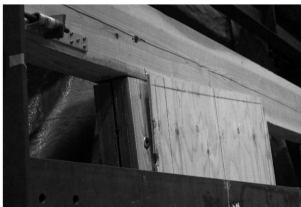
写真 17 最終変形時の合板上部の状況
