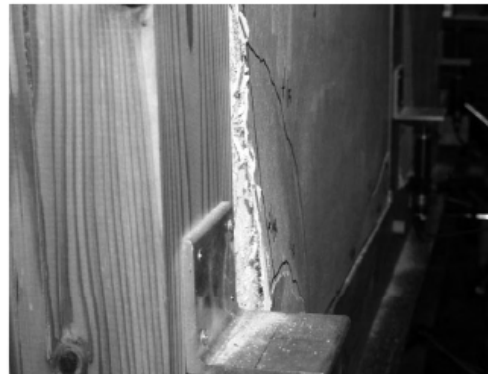
(e) 柱脚部漆喰塗の剥がれ
