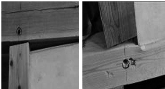
写真 12 加力側柱頭部と柱脚部の浮き
