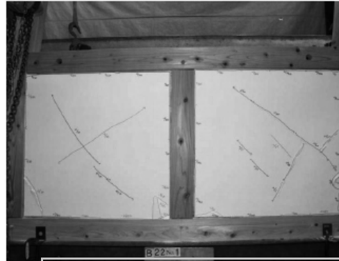
(d) 腰壁の漆喰のひび割れ
