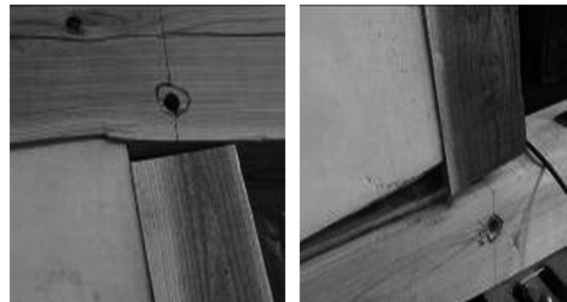
写真 15 中央柱頭部と柱脚部の浮き
