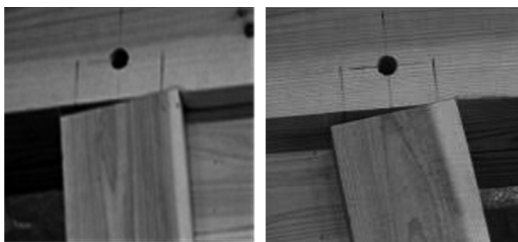
写真6 柱頭隅角部洞差へのめり込み
