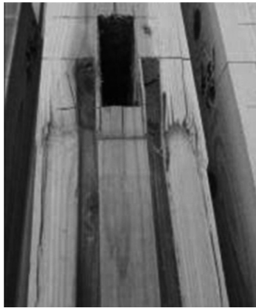
写真 10 塗り壁端面と土台のめり込み
