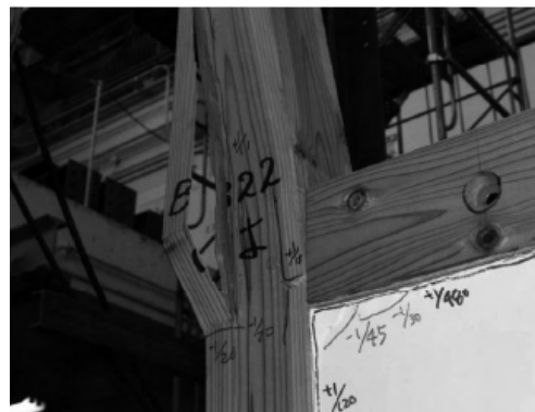
(f) 窓台部加力側柱曲げ破壊
