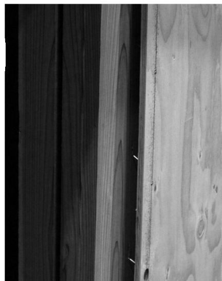
写真 19 合板中間部の浮き
