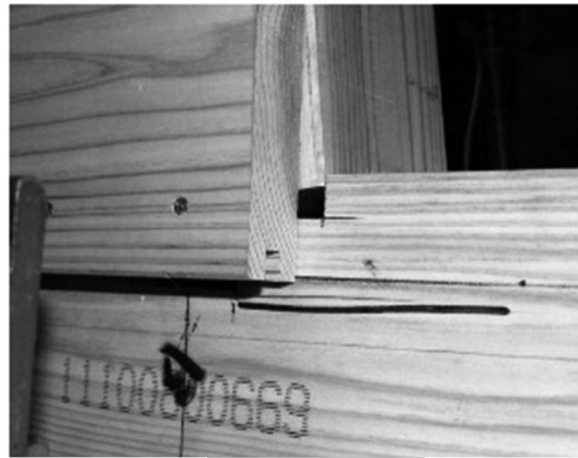
(d)大梁割裂
