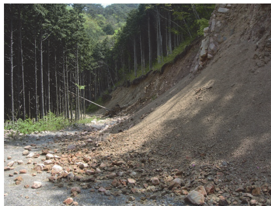
図 4-1-b のり面崩落被害（7 林班）
