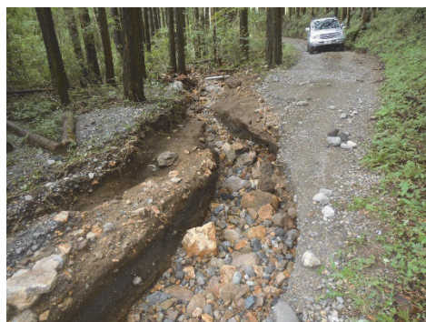
図 4-2 洗堀被害（4 林班つ 1 下部）
