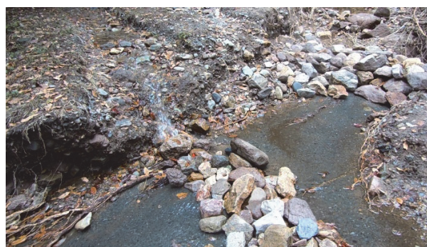
図 4-3 洗堀被害（5 林班な河川横断部）
