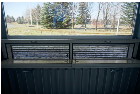
図 5-2-11 自然換気口(内観)
