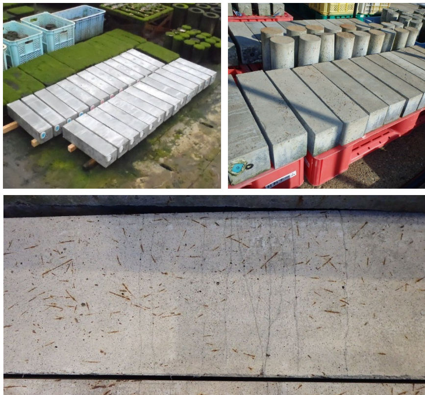
写真6-3 暴露状況(引張縁, ひび割れ面が天端となるよう設置)
